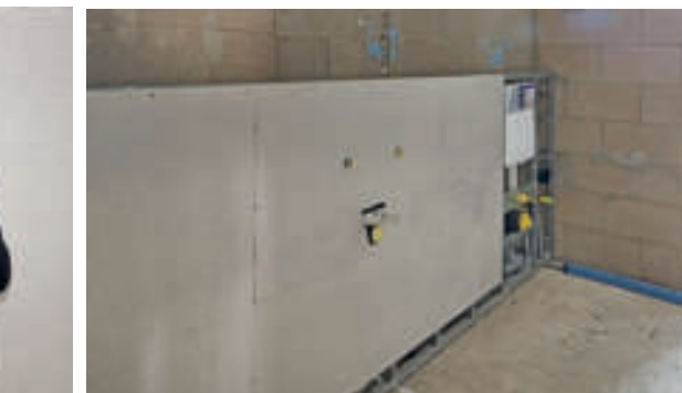
VeroBoard® Rapid ist feuchteunempfindlich. Damit ist die Platte auch ideal für die Montage im Bad. Die Sanitäreinrichtung in Volkesfeld erfolgte als Vorwand-Installation.
