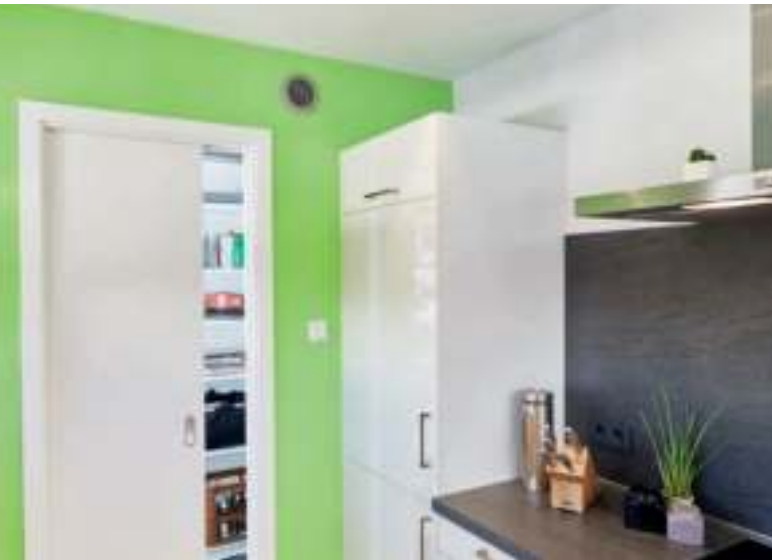
In den Ablufträumen wie der Küche sieht man von der installierten Lüftungstechnik nur einen dezenten, mit einer Edelstahlabdeckung versehenen Abluftauslass unterhalb der Decke.
