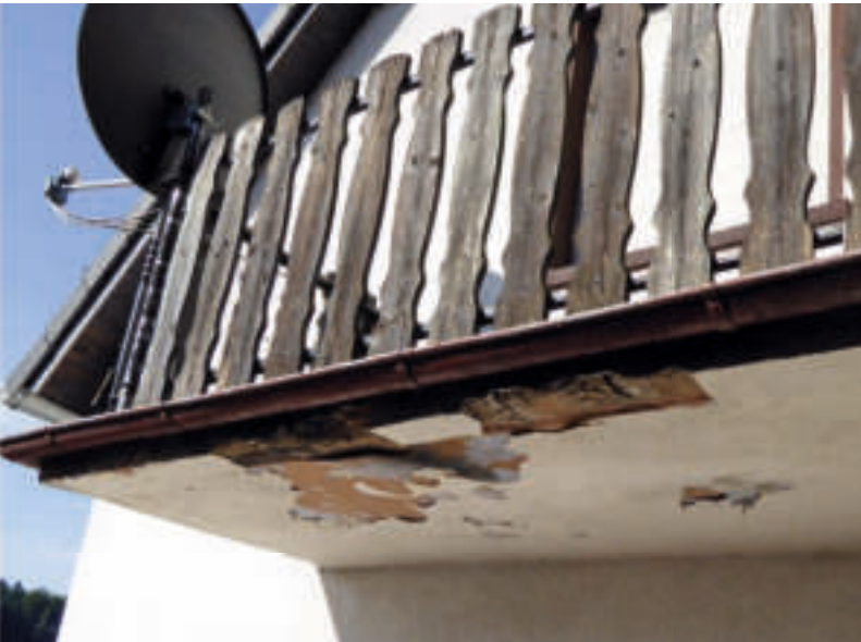
Sind feuchte Stellen oder Abplatzungen an der Unterseite des Balkons zu entdecken, sollten Fachleute zur Prüfung hinzugezogen werden.
