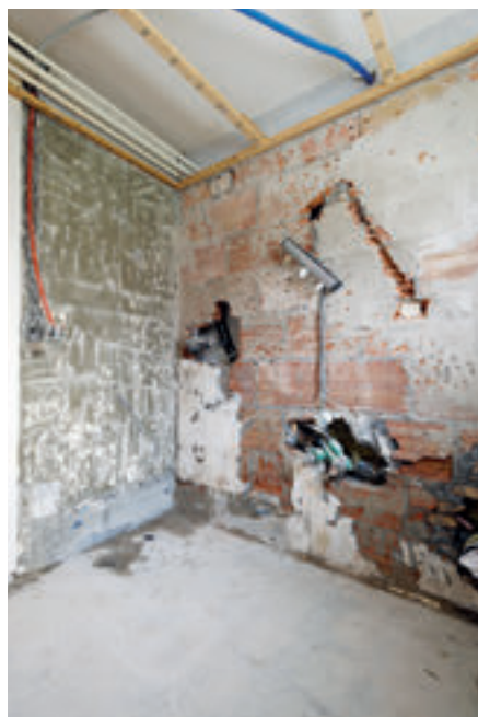
Auch die Holzdecke wurde entfernt, Wasser- und Abwasserleitungen sowie Stromanschlüsse wurden angepasst und an die richtige Stelle versetzt.
