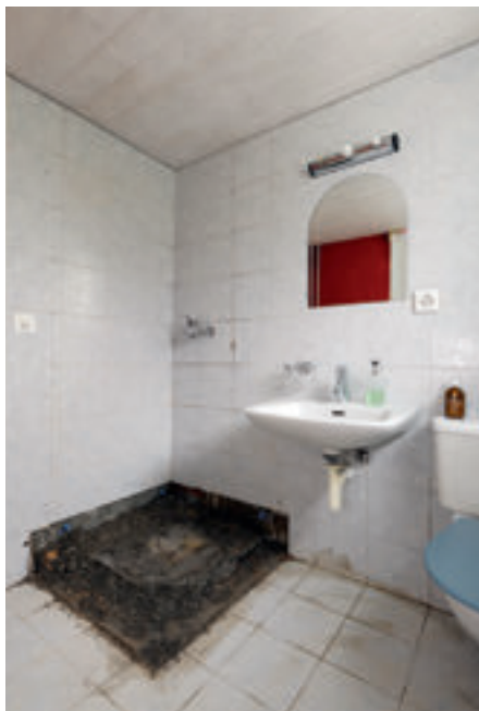
Im ersten Schritt musste die bestehende Duschkabine und die stahl-emaillierte Duschtasse demontiert und entsorgt werden.
